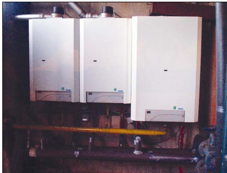
Котловско постројење инсталисане снаге 200 kW
