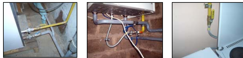
Слика: Запорни вентил испред трошила
